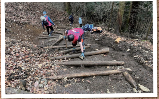
土壌が流出した階段部分（下岳山）
